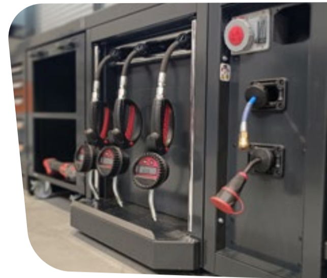
Detail integrovaného olejového hospodářství a energetického hnízda v tréninkovém centru
