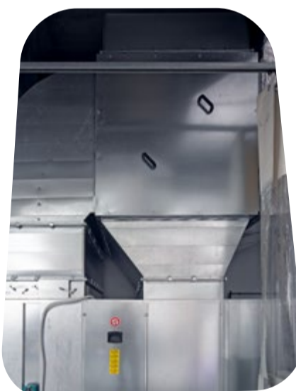
Rekuperační jednotka instalovaná na boční straně nového lakovacího boxu Termomeccanica
