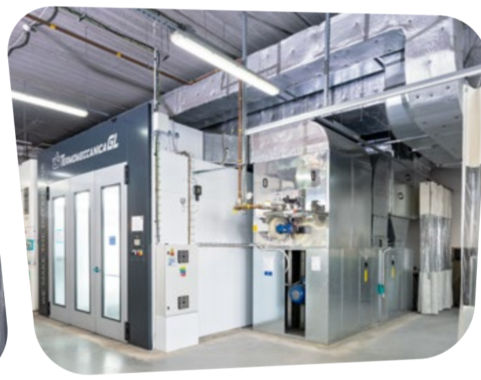
Nový lakovací box Termomeccanica s rekuperační jednotkou pro úsporu energie
