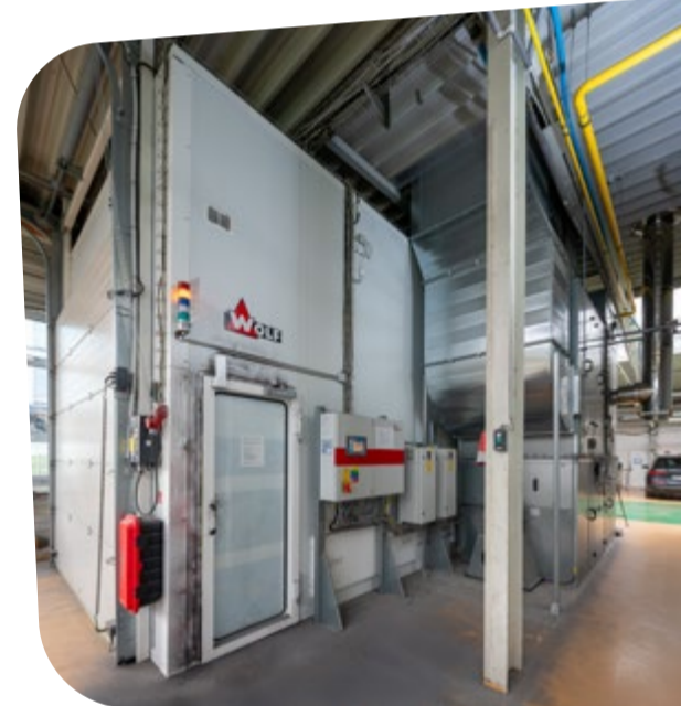
Nový lakovací box byl osazen rekuperační jednotkou pro úsporu energie
